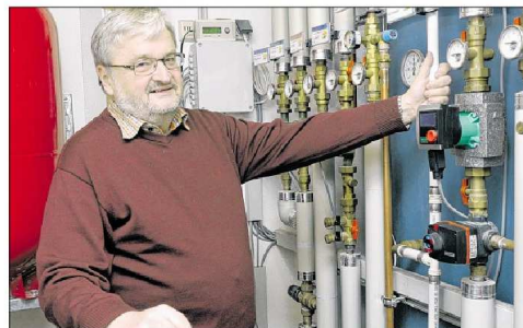
PETER GRIEBEL heizt sein Haus in Sasbachwalden mit Solarenergie und einer Pelletsheizung. Foto: emg
